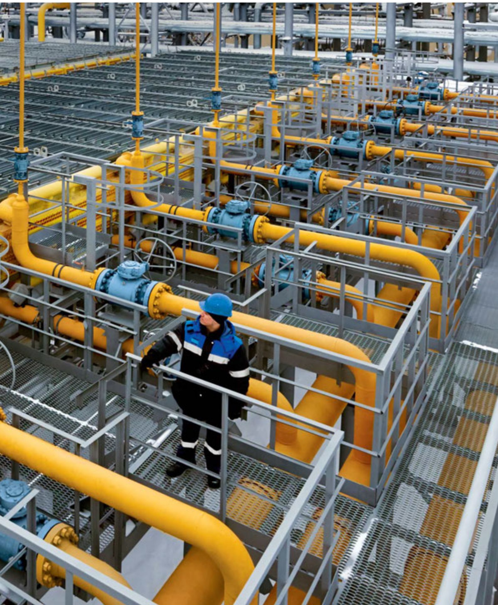
Юрхаровское месторождение, дожимная компрессорная станция. Март 2014
